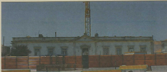
A antiga escola primária da Vera Cruz vai dar lugar à sede da junta de freguesia
