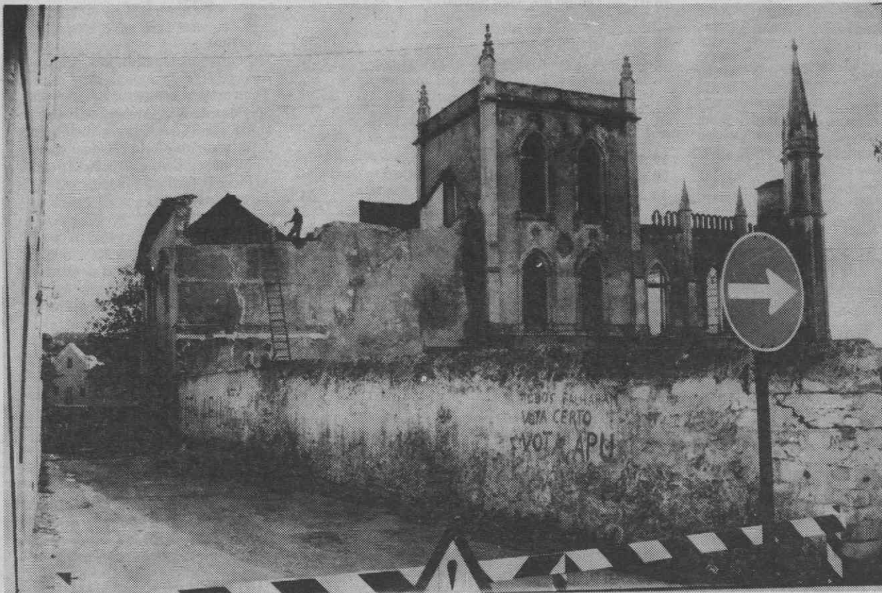
Como se pode observar na foto, operários procedem à demolição de parte do Paço de Tavarede, confinante com a via pública.
