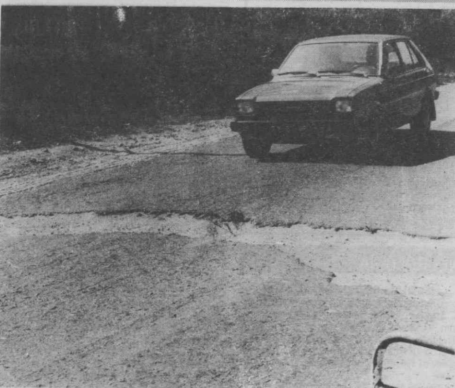
Aspecto do buraco que constitui um perigo para os muitos utentes da estrada Águeda-Valongo do Vouga.
