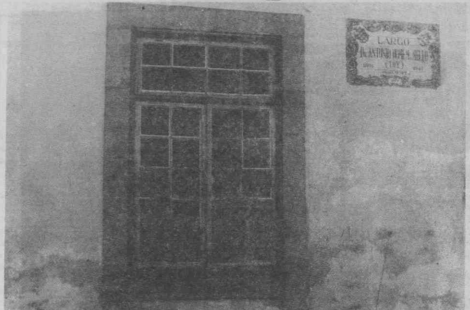
A degradação do edifício aumenta de dia para dia.
