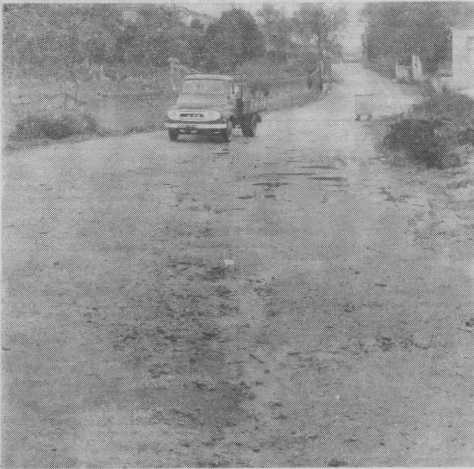
Um dos locais onde o pavimento se encontra mais degradado, já dentro da provação de Trofa do Vouga.
