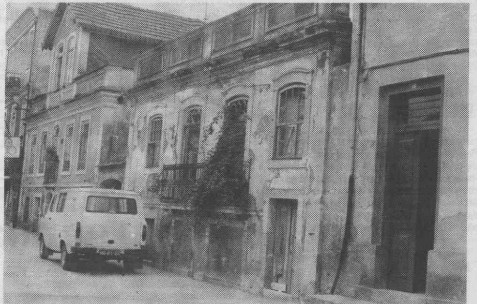
Um dos edifícios que ameaçam derrocada.
