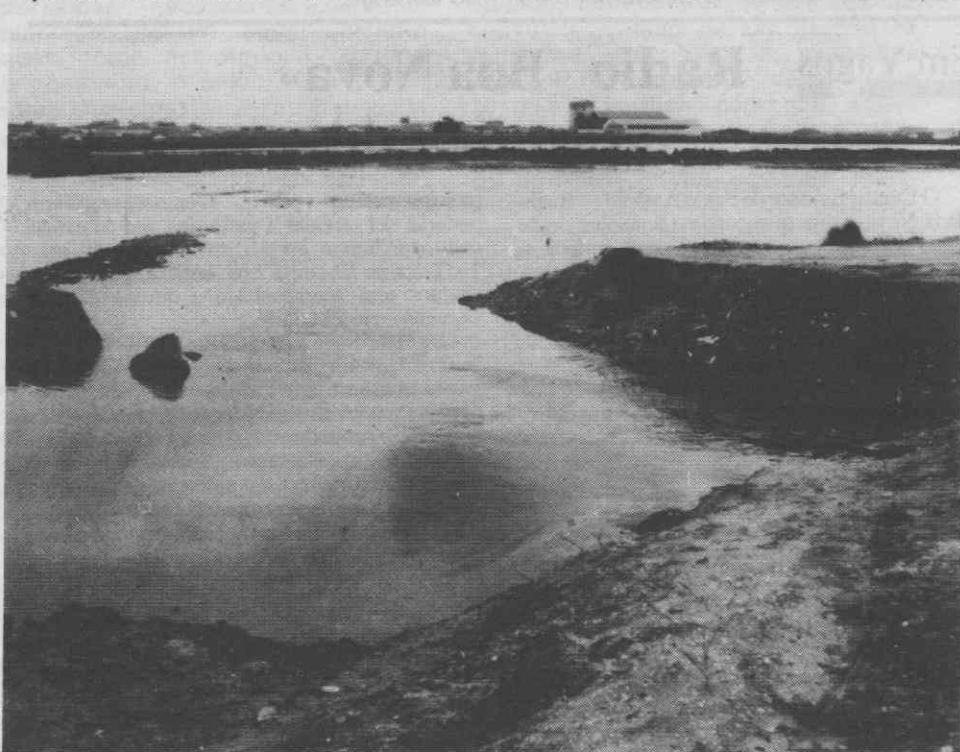
O muro do viveiro de piscicultura, destruído pelas manilhas do Esteiro de Sá.
