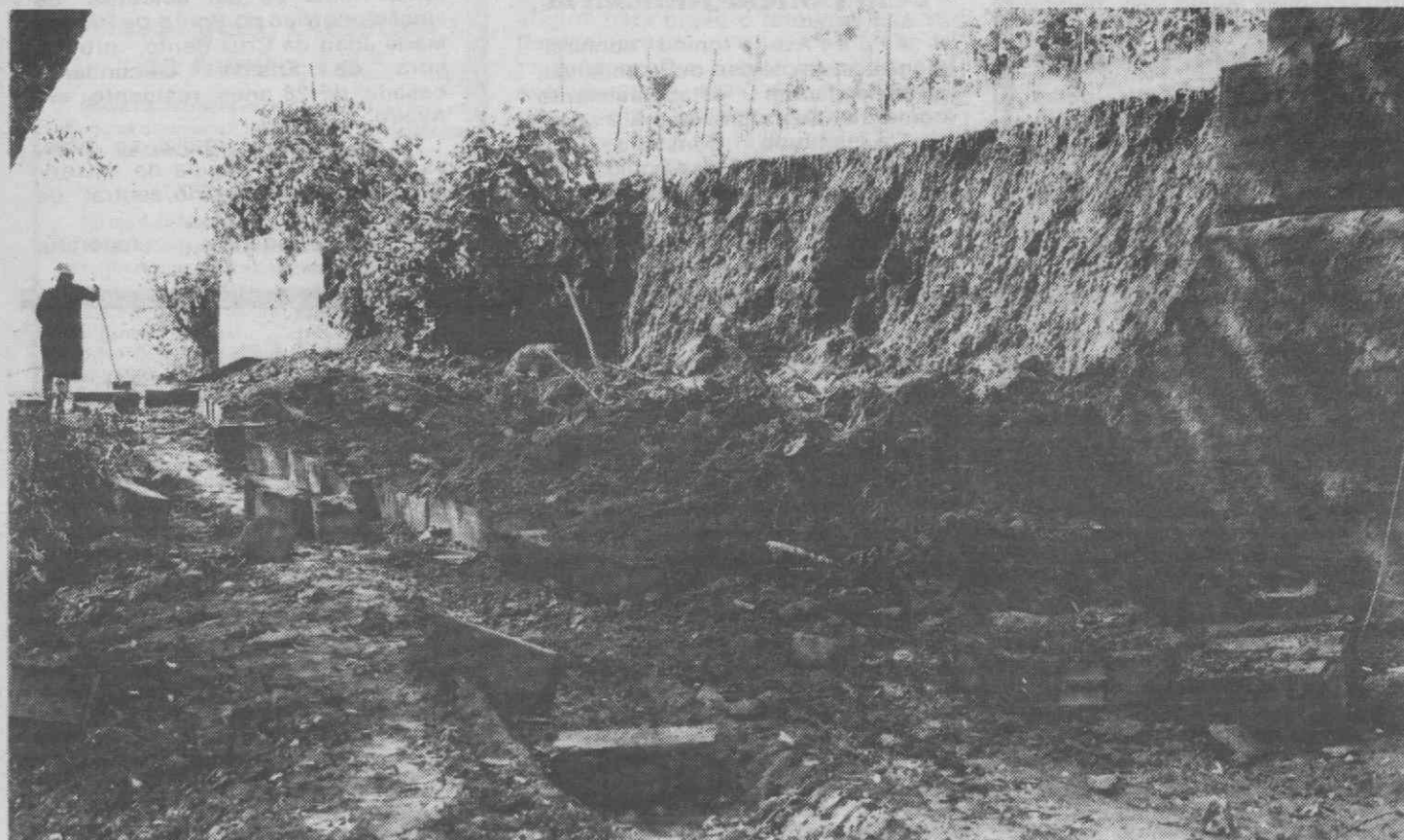
Este muro tombou na sequência dos trabalhos de alargamento do caminho.
