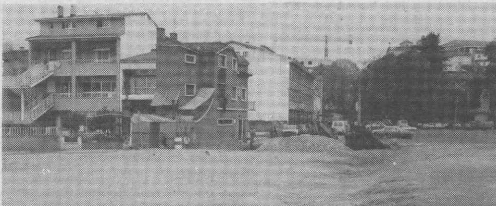
Depois da pavimentação dos acessos à Ponte do Ribeirinho, as obras continuam na Rua Celestino Neto.
