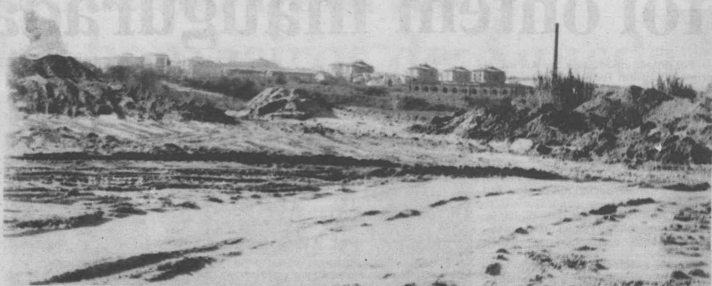
As obras de terraplenagem dos terrenos de futuras avenidas estão em fase já adiantada.
