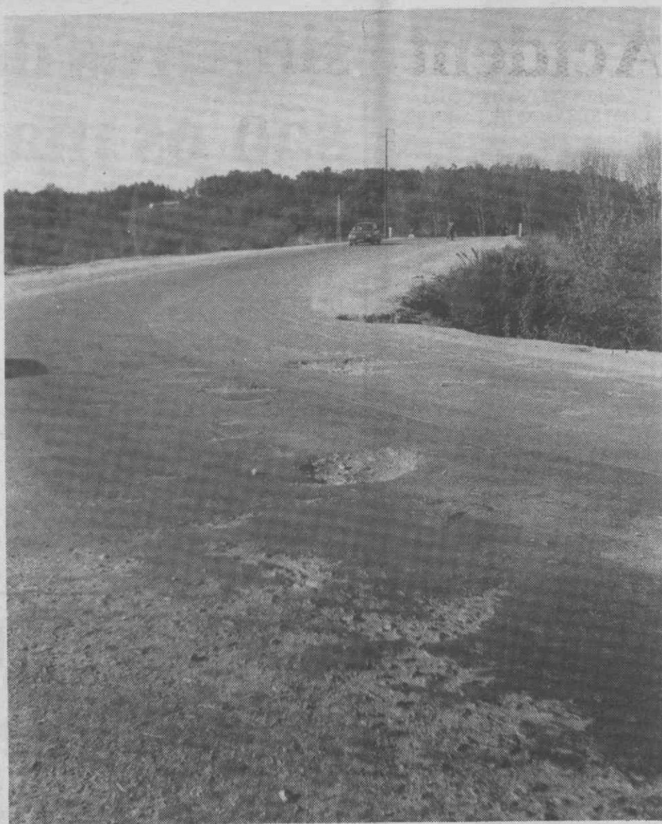
O pavimento dos acessos à Ponte do Ribeirinho deverá ser repostado em breve.
