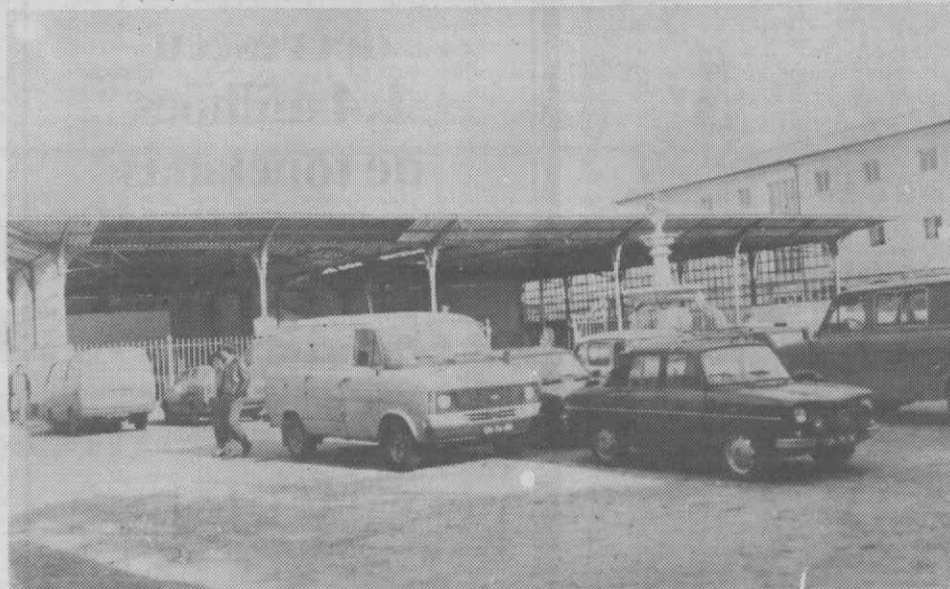
Um aspecto das obras de arranjo, recuperação e embelezamento da zona envolvente da Praça do Peixe.
