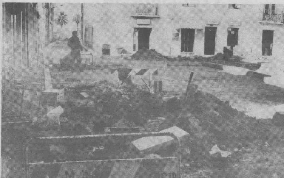
Estão em curso as obras de arranjo da zona envolvente da Praça do Peixe, um projecto que restituirá à Praça a beleza que outrora a caracterizou.
