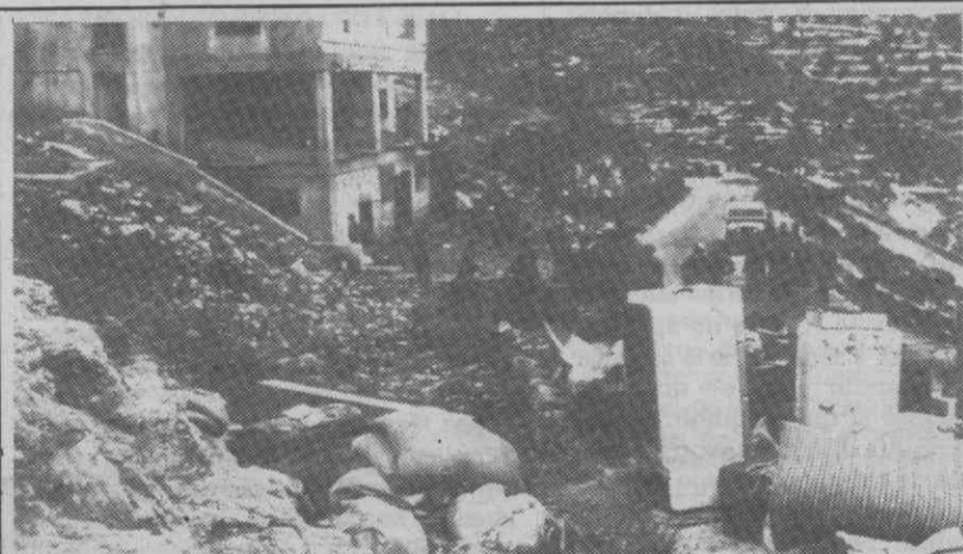
NABLUS (TERRITÓRIOS ÁRABES OCUPADOS) — Soldados israelitas retiram os moradores de uma das quatro casas que irão demolir, após um membro desta família ter sido considerado culpado de apoiar guerrilheiros palestinianos.
