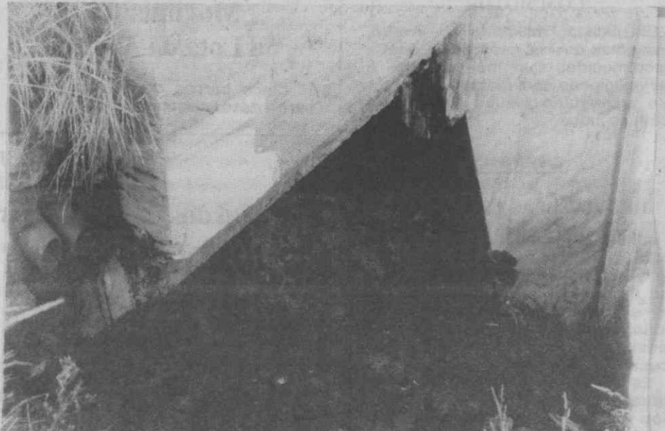
Este bloco já arreou 10 centímetros e faz temer que outros desmoronamentos ocorram com prejuízos acrescidos.
