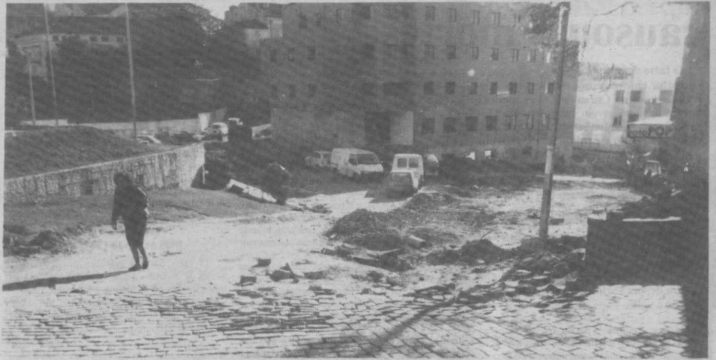
As obras na Rua Fernando Caldeira não se encontram devidamente assinaladas.
